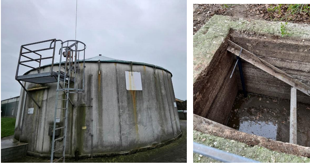
Abbildung 2: Fotos der Güllelager (links: Güllelager 1 mit Rindergülle – Biogasanlage 5 U; rechts: Güllelager 2 mit Schweinegülle – Lager 6 U)
